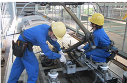
パンタグラフの点検
