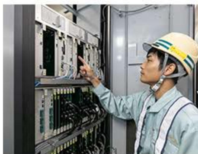
電子交換機の定期検査
