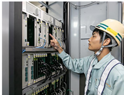
電子交換機の定期検査
