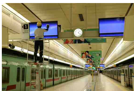
案内表示器の定期検査
