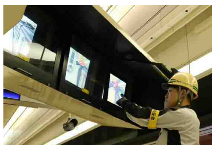
ホーム監視装置の定期検査
